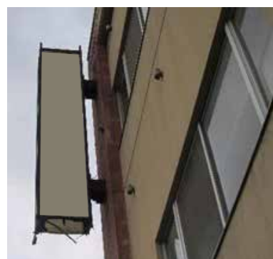
腐食を放置し、底部に穴が空いた例
